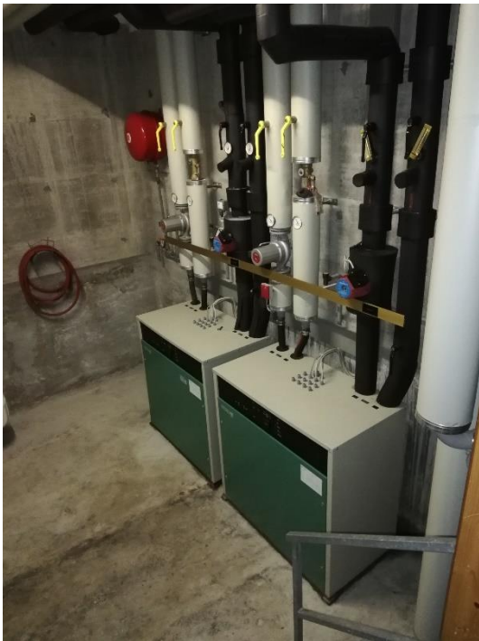
pumpa da scaldar existentia
